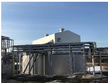
食品残渣などを発酵させる発酵槽
